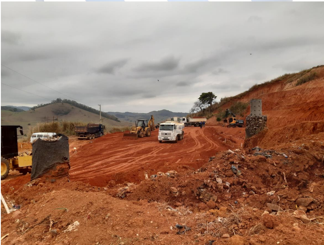
Foto 04: Início da execução do dique de solo da área norte do aterro sanitário
