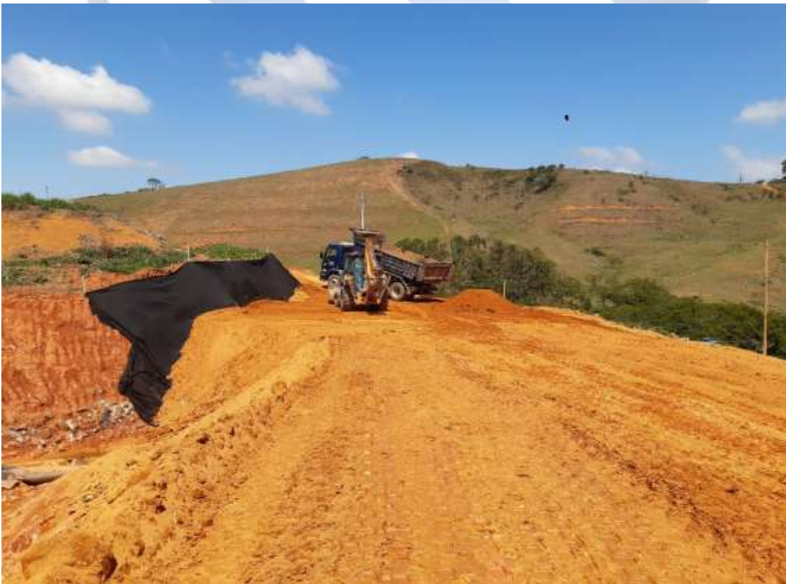
Foto 02: Lançamento de solo para compactação do dique da área norte do aterro sanitário
