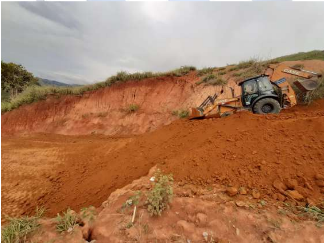
Foto 04: Lançamento de solo para compactação do dique da área norte do aterro sanitário
