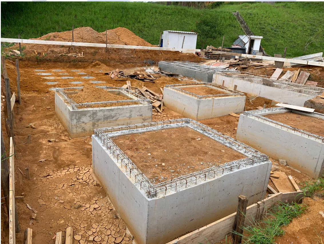
Foto 4 – Início da armação das ferragens para a laje das bases dos filtros.
