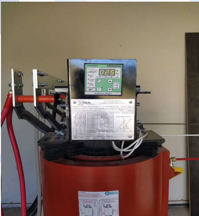
Foto 12 – Transformador 02 com seu circuito de controle energizado.
