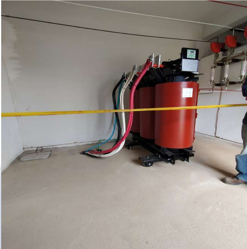
Foto 09 – Transformador 01 instalado e interligado na rede interna
