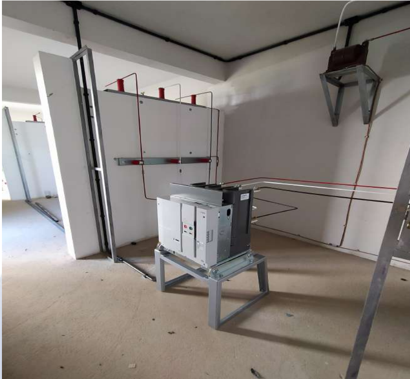
Foto 13 – Disjuntor de media tensão instalado.
