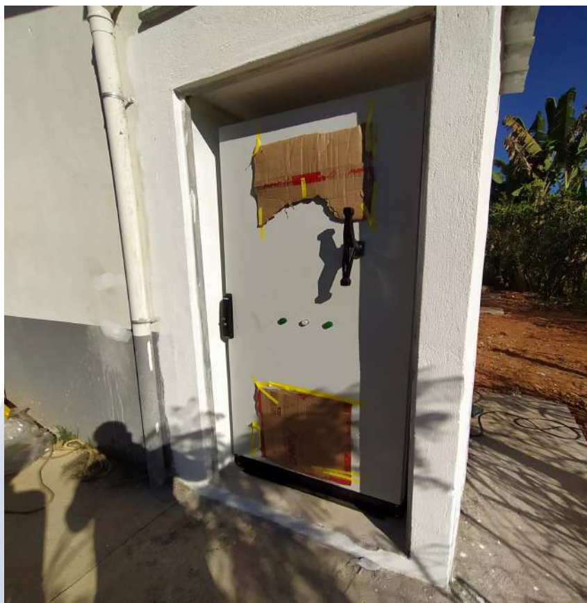
Foto 05 – QGBT Instalado no local definitivo.
