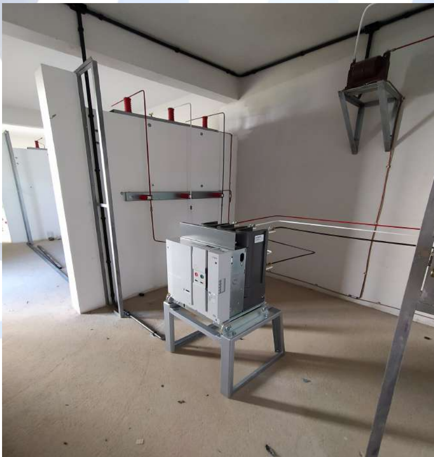
Foto 13 – Rede de media tensão interligada com os equipamentos.
