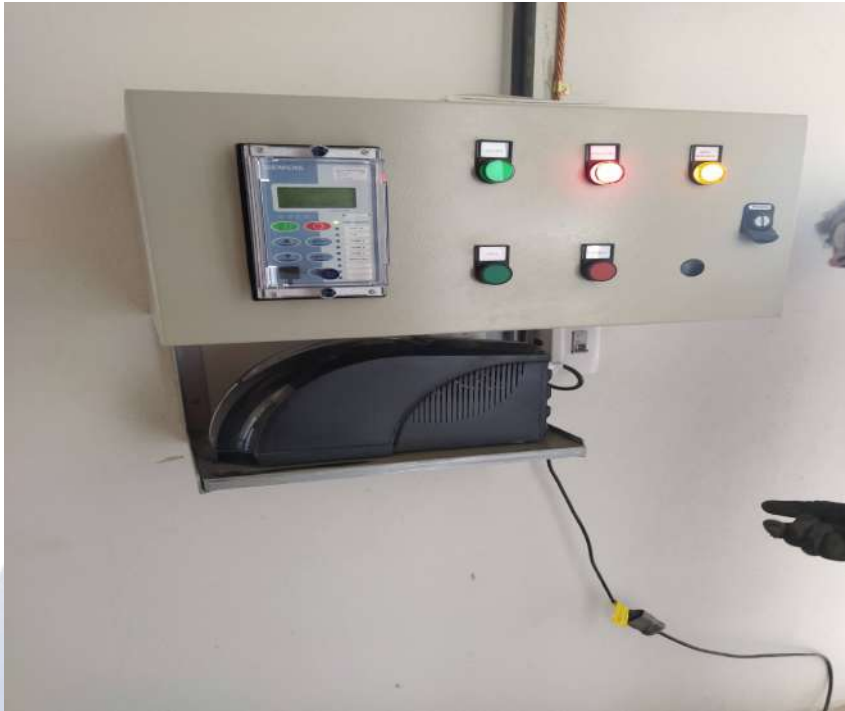
Foto 14 – Sistema de controle e segurança do disjuntor de media tensão.
