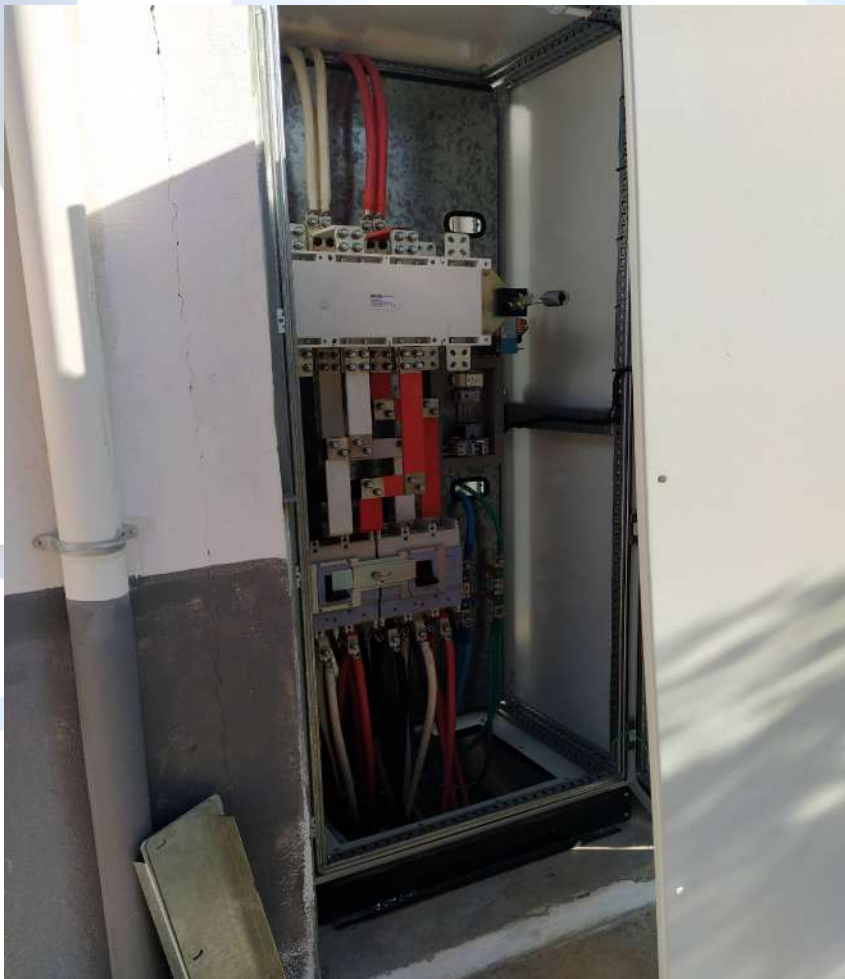
Foto 15 – QGBT com vista interna dos componentes.
