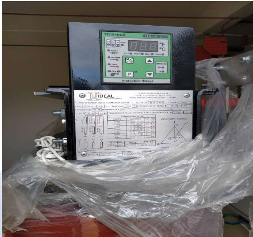
Foto 07 – Detalhe da placa de controle do transformador.
