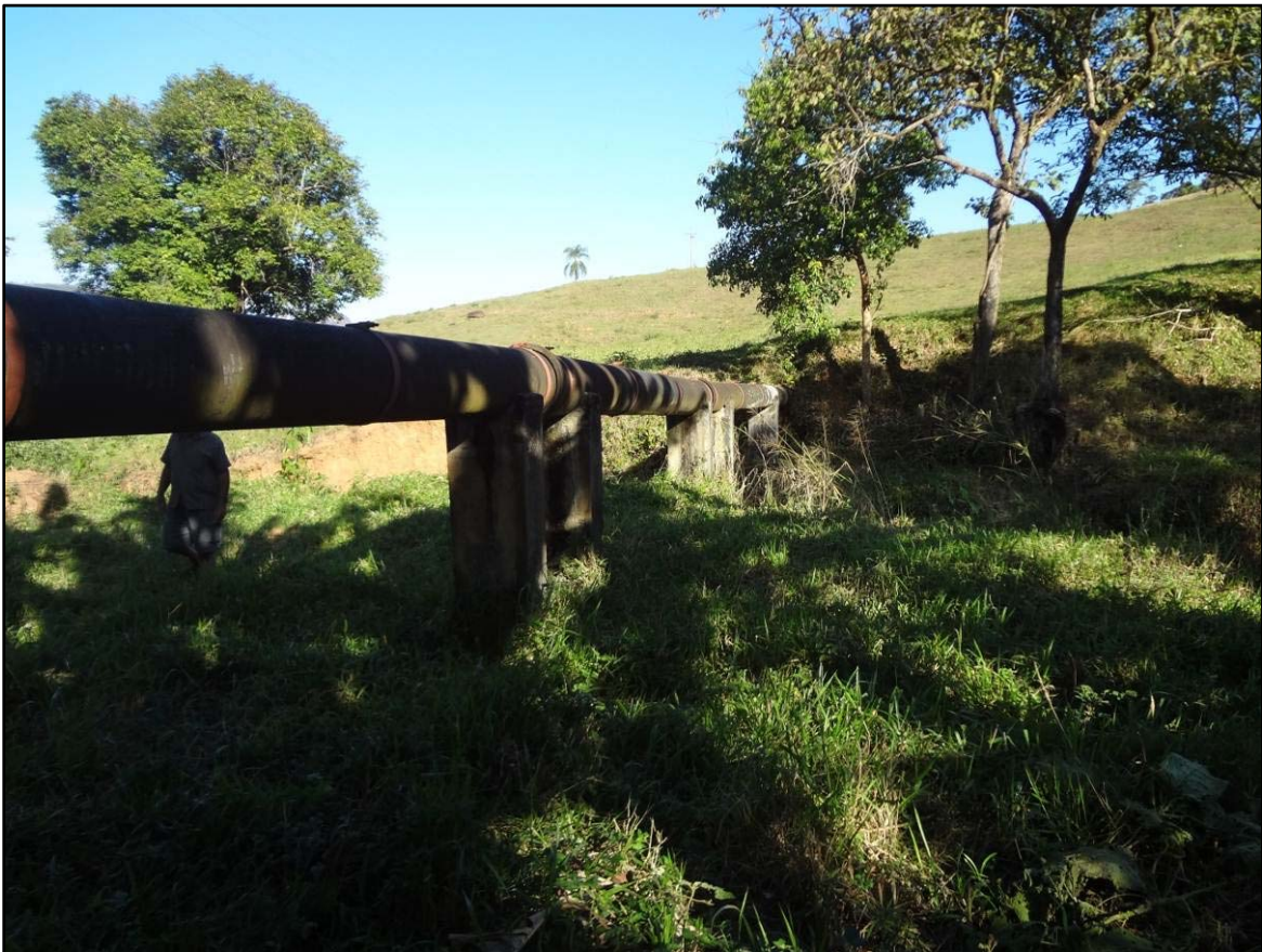
Figura 2.5. Adutora de Água Bruta no rio do Glória e adução até a ETA da Gávea.
