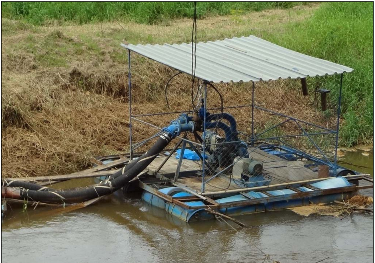
Figura 2.76. Captação superficial no Rio Preto.
