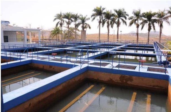
Figuras 2.72 e 2.73. ETA Gávea.
