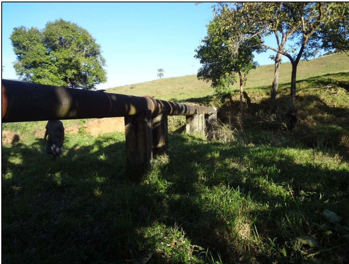
Figura 2.64. Adutora de Água Bruta no rio do Glória e adução até a ETA da Gávea.
