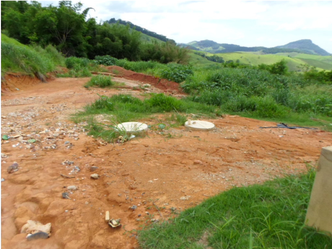
Sistema fossa-filtro dos banheiros do galpão.
