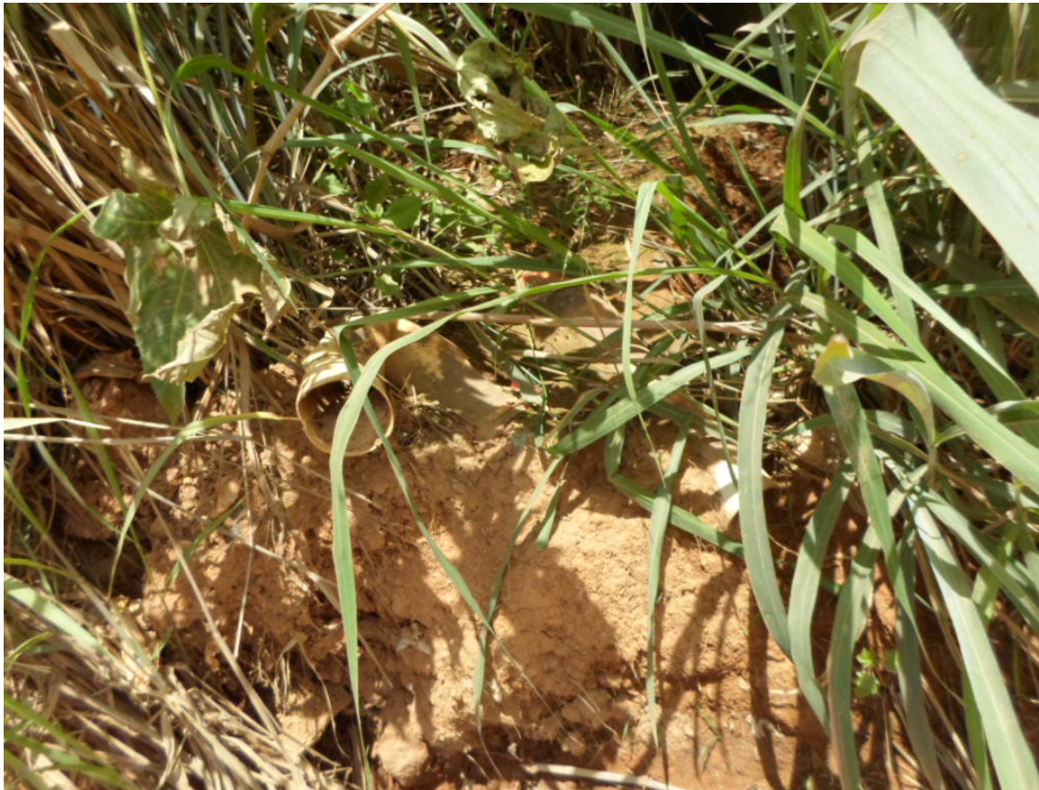
Detalhe da tubulação de condução de chorume rompida.
