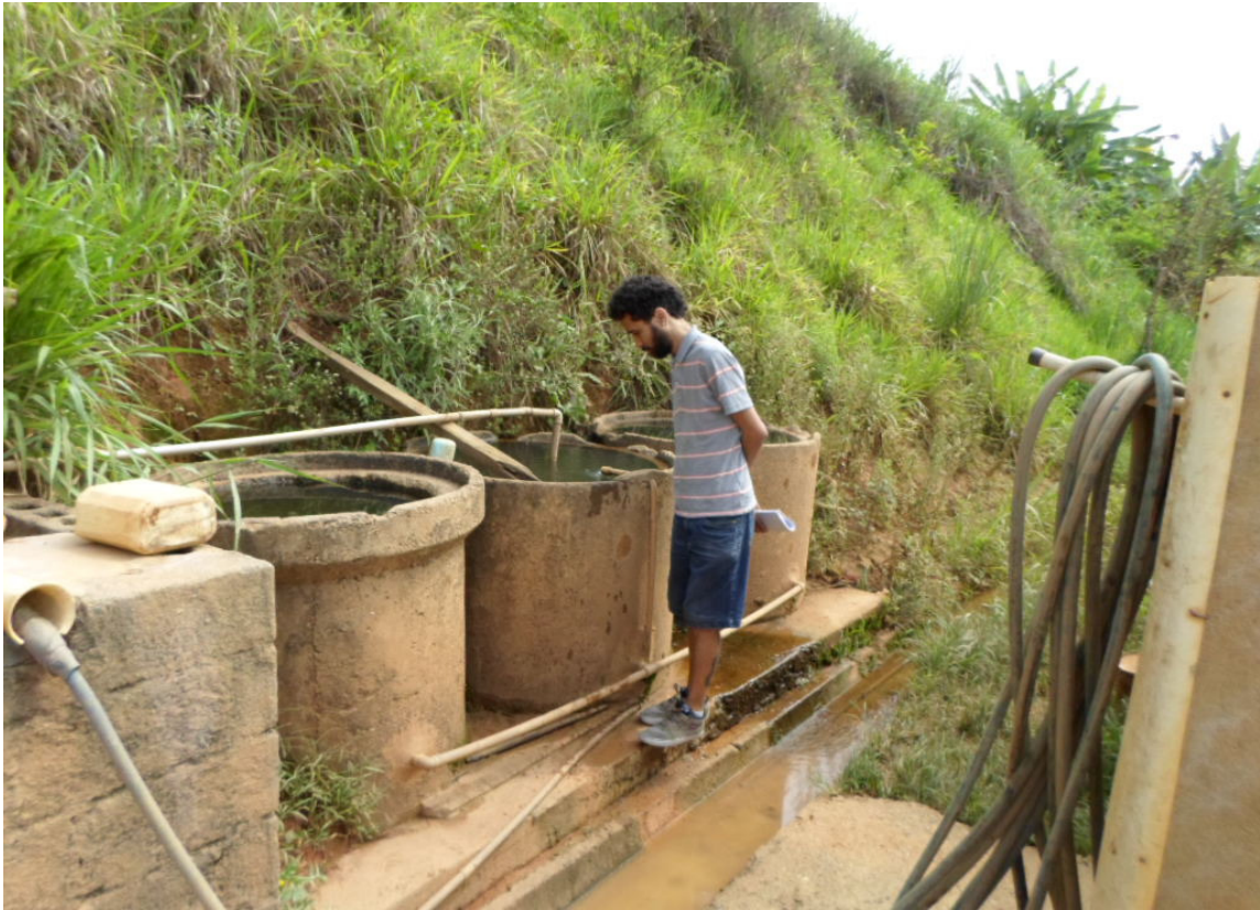
Cisternas para acumulação de água de lavagem de carros.
