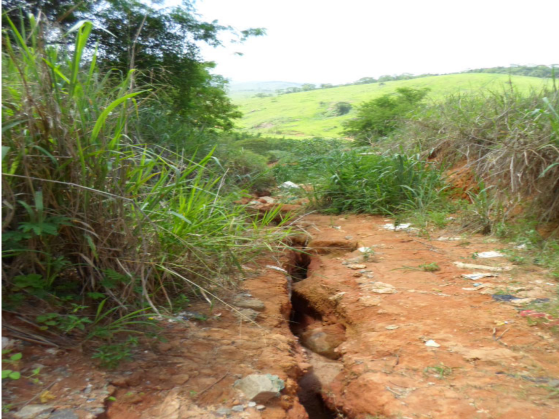
Erosão em área lindeira à estrada de acesso ao aterro.
