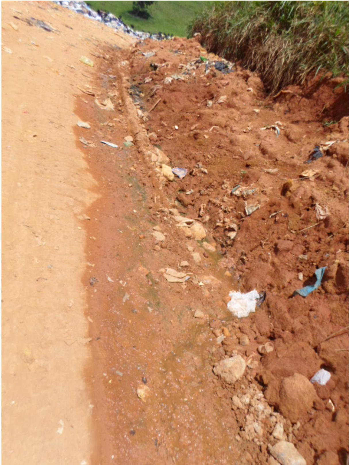
Afloramento de chorume em pé de talude.
