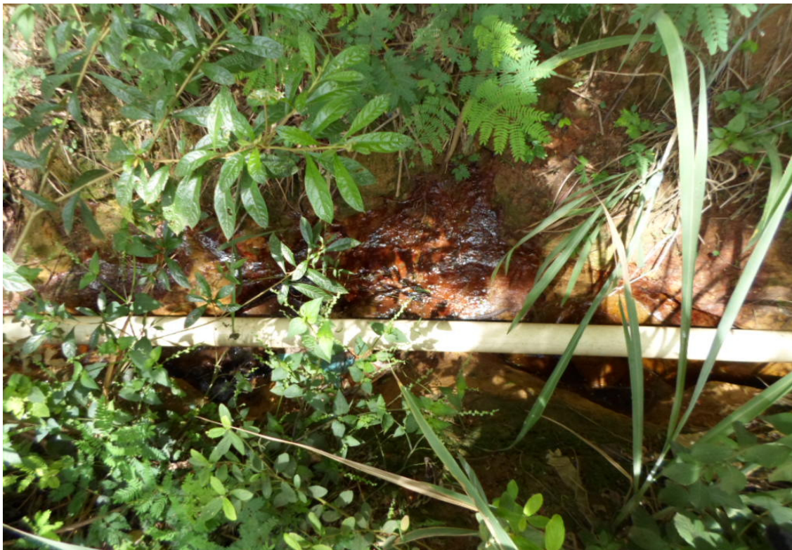
Canaleta de condução de efluente do aterro, com detalhe para o chorume exposto no solo, o que indica drenagem insuficiente e conseqüente infiltração no solo ou tubulações de condução rompidas.
