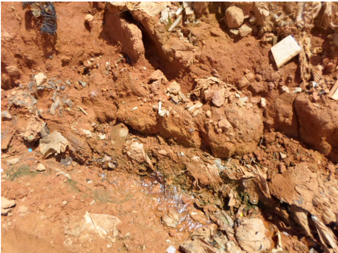
Afloramento de chorume em pé de talude.
