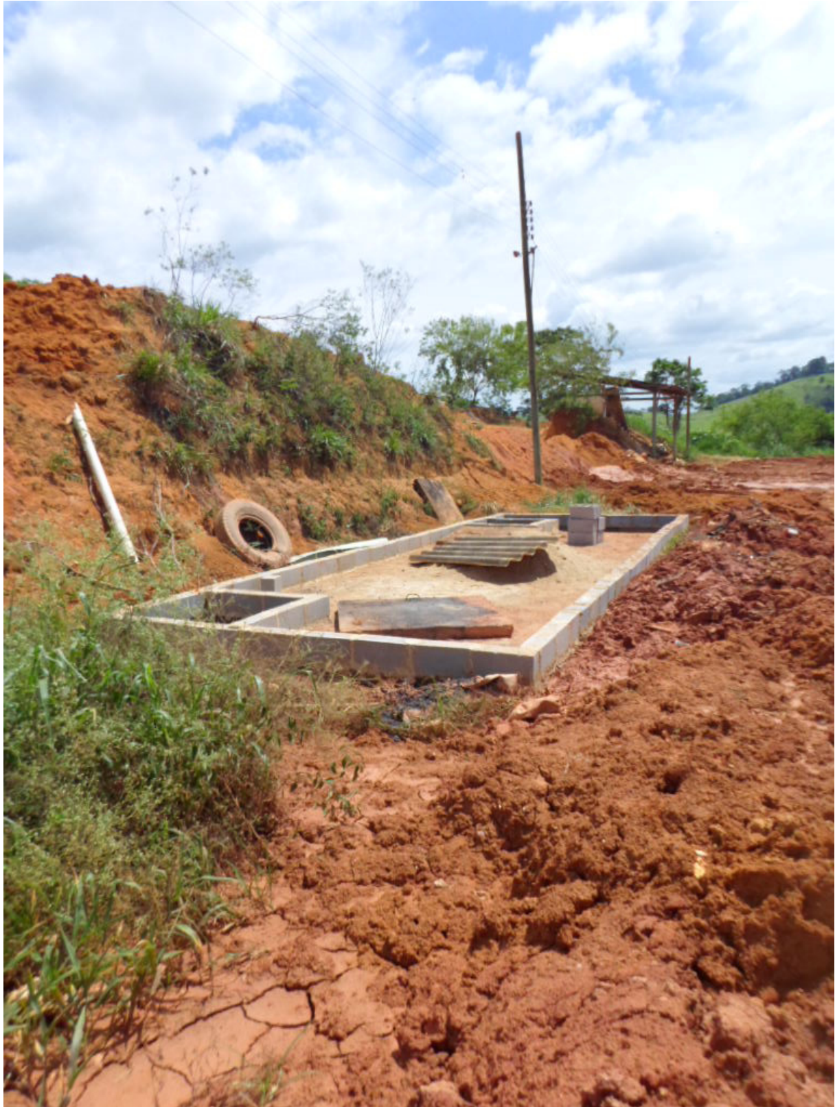
Caixa de acumulação e tratamento de chorume, com volume estimado em 100.000 L. A caixa é dividida em duas células independentes, sem impermeabilização, a qual é limpa 3 vezes por semana, segundo informações do encarregado da unidade.
