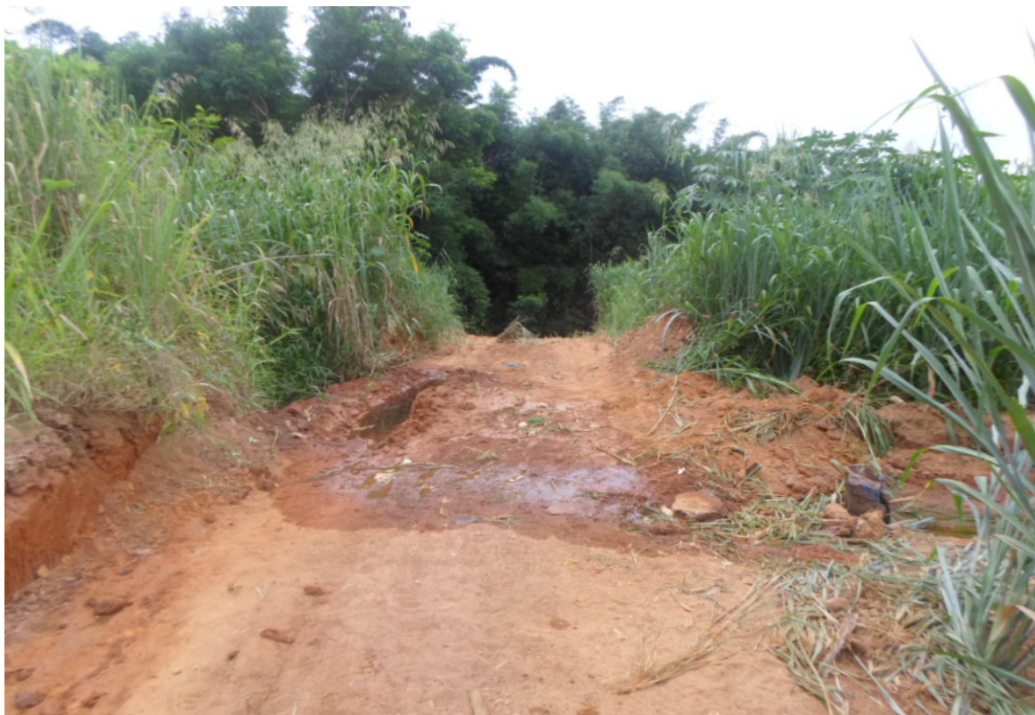
Figura 6: Área com infiltração de água pluvial próximo a estrada de acesso ao primeiro poço de monitoramento.
