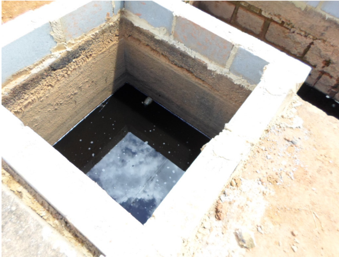
Detalhe do chorume acumulado na caixa.
