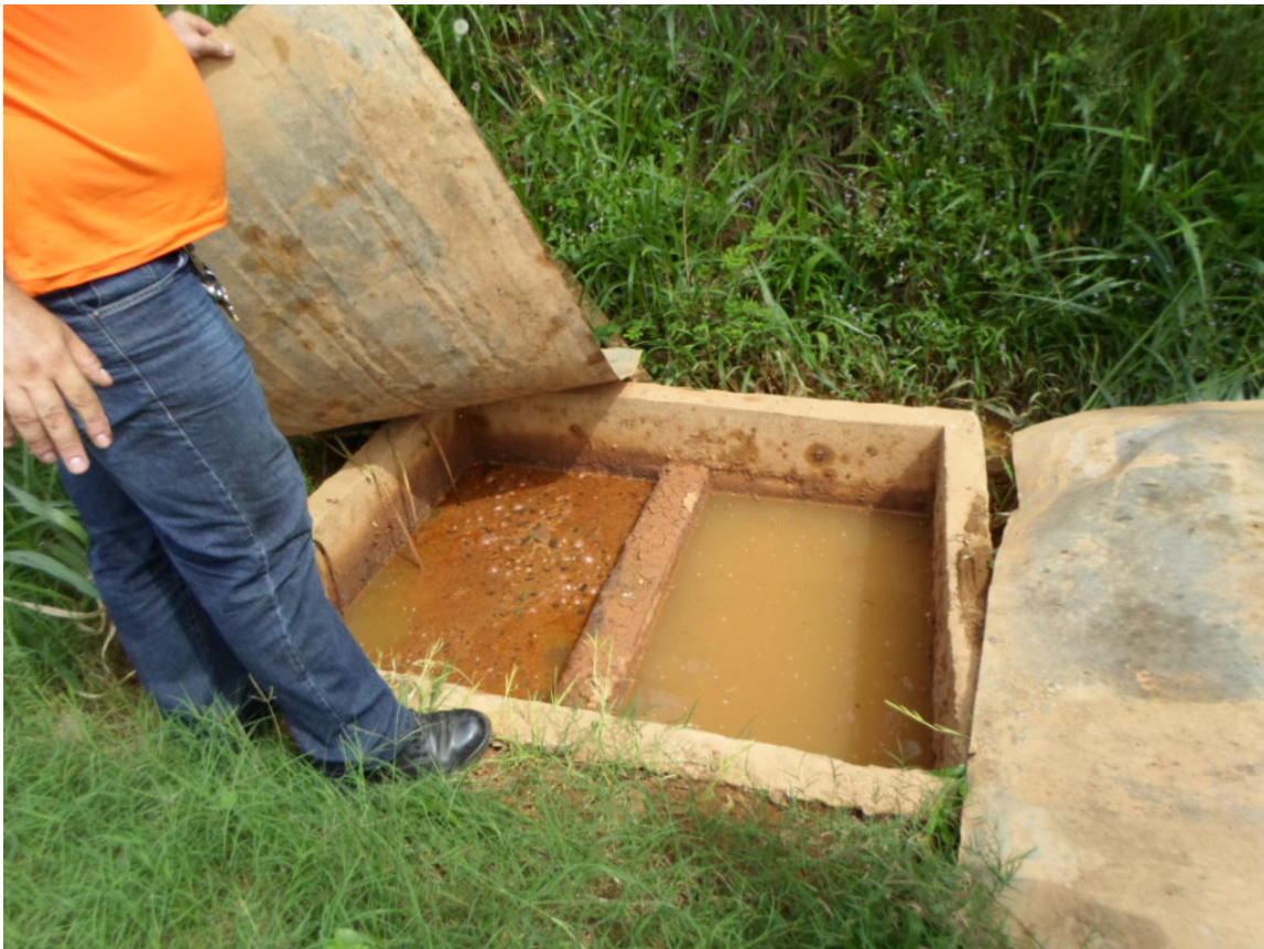
Caixa separadora de água e óleo para efluentes de lavagem de carros.
