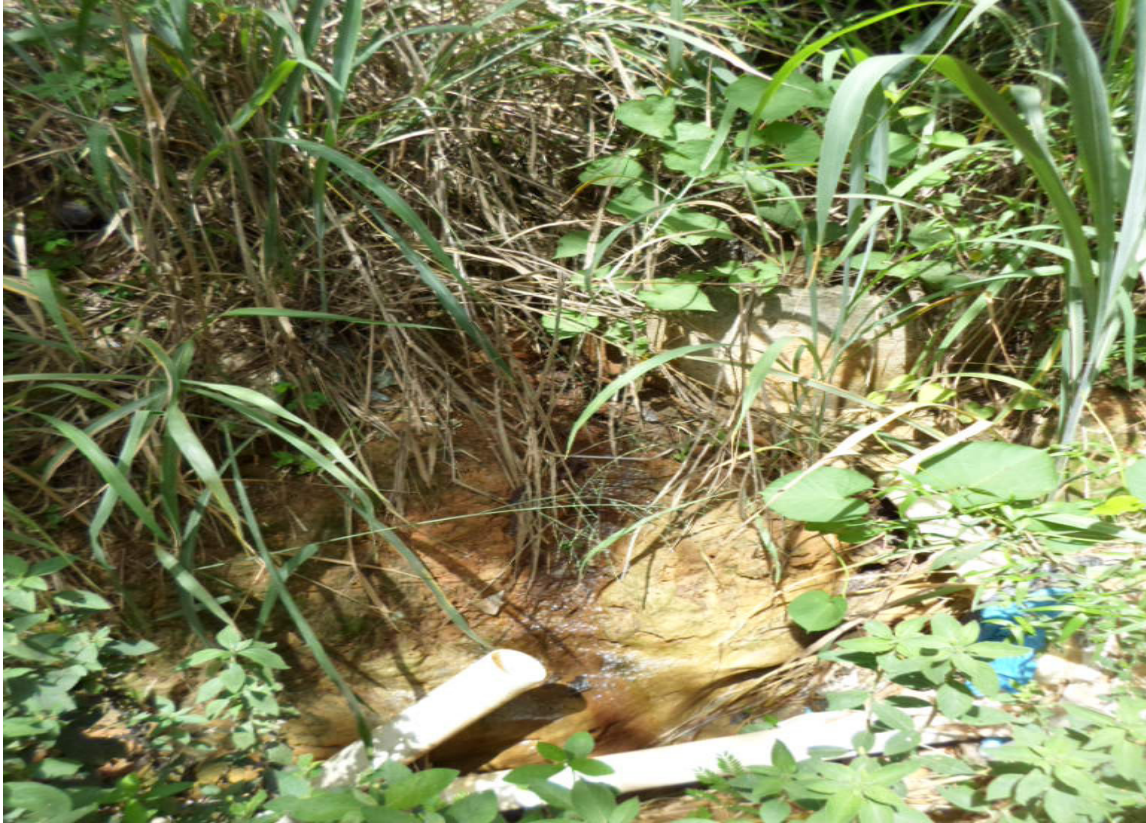
Detalhe da tubulação de condução de chorume rompida.
