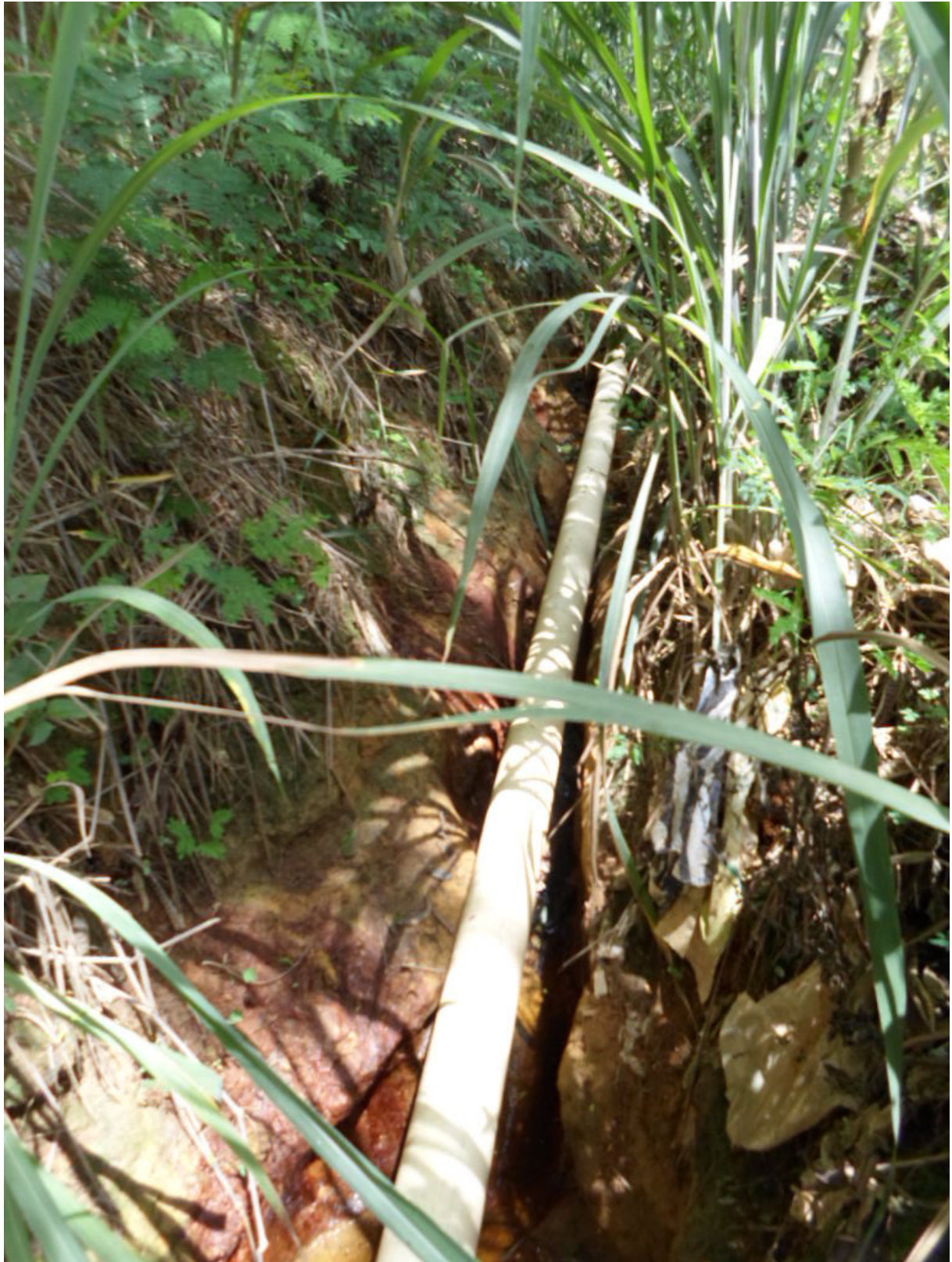
Canaleta de condução de efluente do aterro, com detalhe para o chorume exposto no solo.
