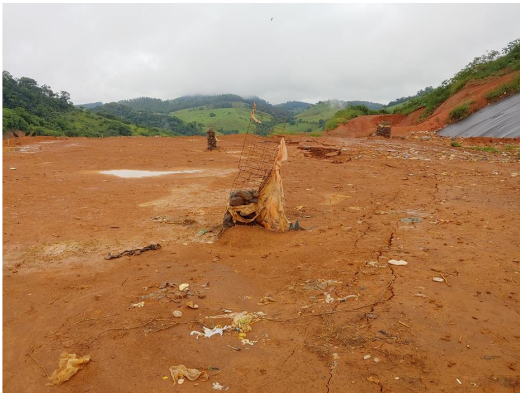
Foto 6.3- Foto das trincas 4/3/2020
