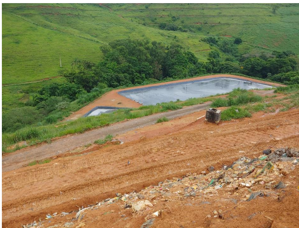
Foto 8.10- Lagoas de acumulação de percolato
