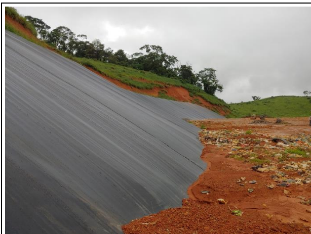
Foto 8.4- Geomembrana conduzindo água pluvial para o aterro
