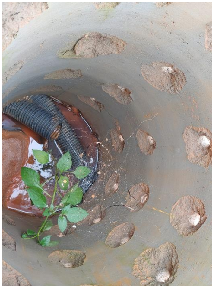
Foto 8.2. Dreno vertical inoperante
