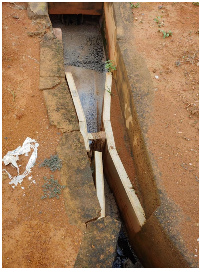
Foto 8.11 _ medidor de vazão de percolado danificado
