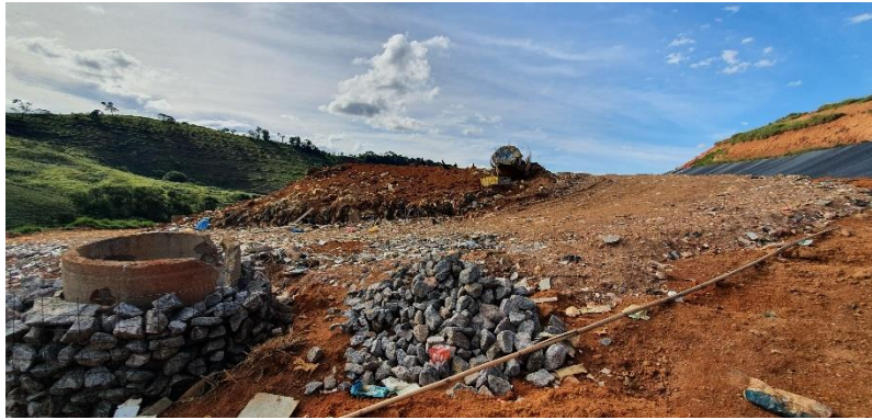
Foto 12. Resíduos domiciliares dispostos sem cobertura.
