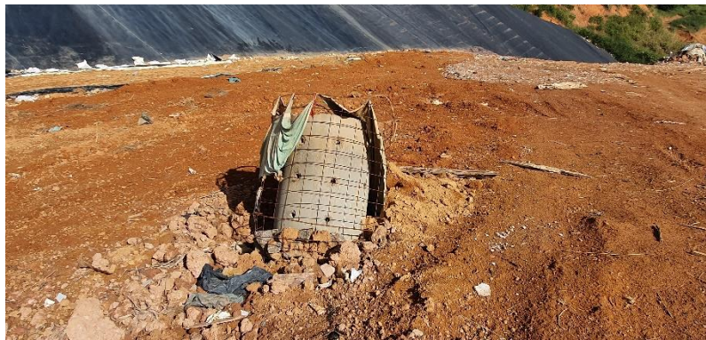
Foto 5. Dreno de biogás comprometido.
