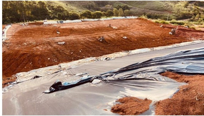
Foto 4. Área de surgimento das trincas.
