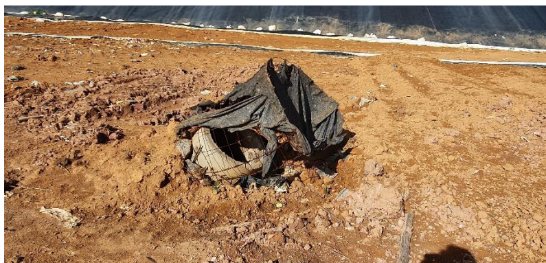
Foto 6. Outro dreno de biogás comprometido.
