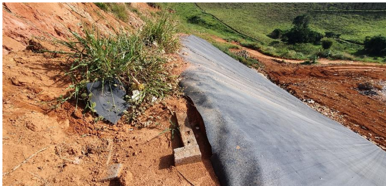
Foto 13. Drenagem pluvial assoreada.
